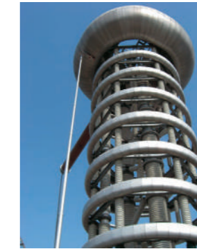
避雷機用 (設備プラント)
